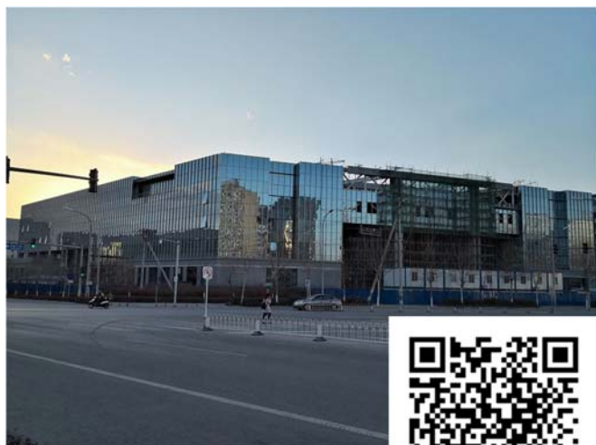
図 1 北京郊外に建設中の北京耐威科技股份有限公司 (Beijing NAV Technology) 傘下の Silex Technology の 8 インチ MEMS 工場 (2019 年 3 月撮影) 詳細は QR コードから
